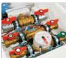
meracie a výmennikové stanice - meranie spotreby energie
