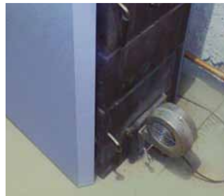
Ventilátor umiestnený na dverkách kotla.
