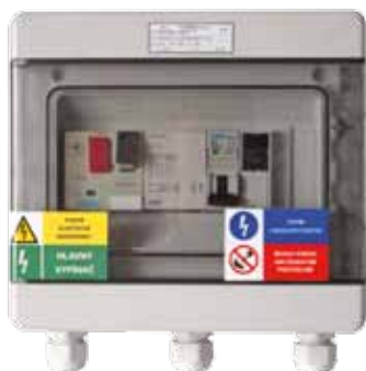
elektrický rozvádzač pre plavákový spínač
